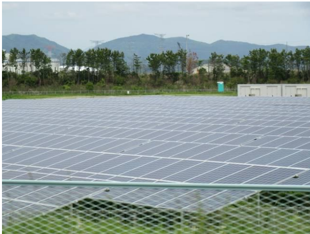
Photovoltaikanlage in Küstennähe
